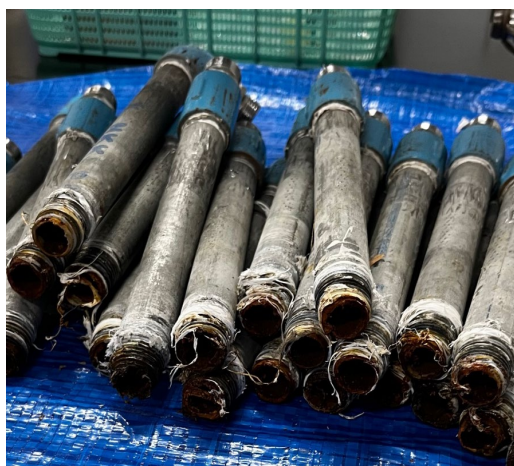
老朽化した配管部分
